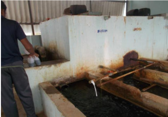
Raw effluent Collection tank
