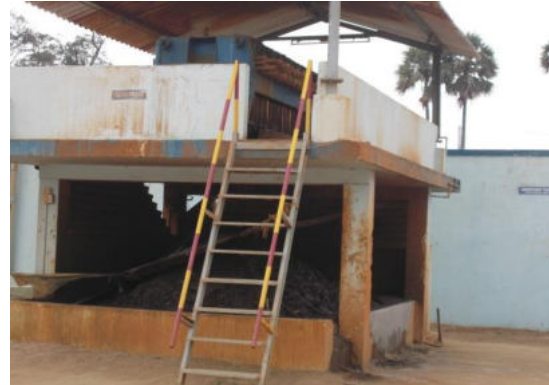
Filtre press for sludge dewatering
