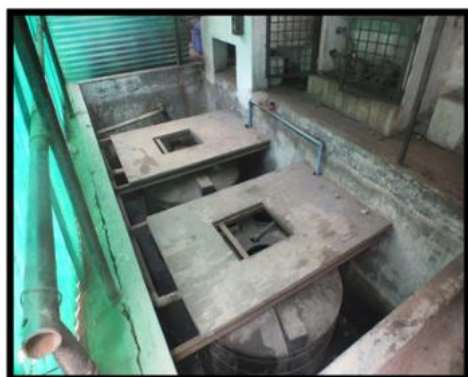
Effluent Collection Tank
