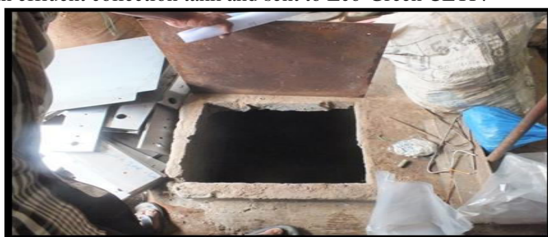
Effluent collection tank
