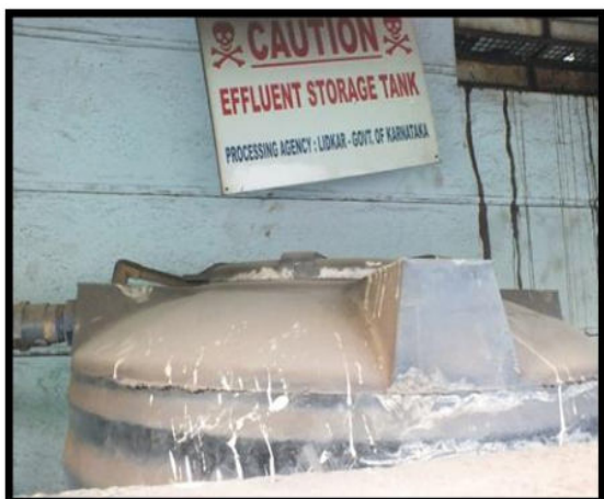
Effluent Collection Tank
