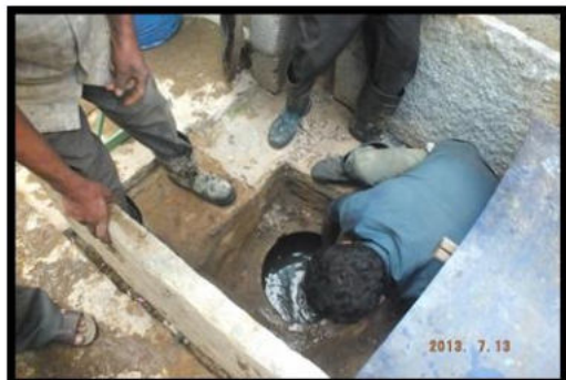
Effluent Collection tank
